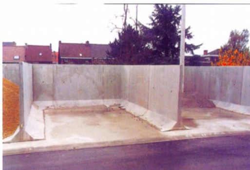
cellules de stockage
